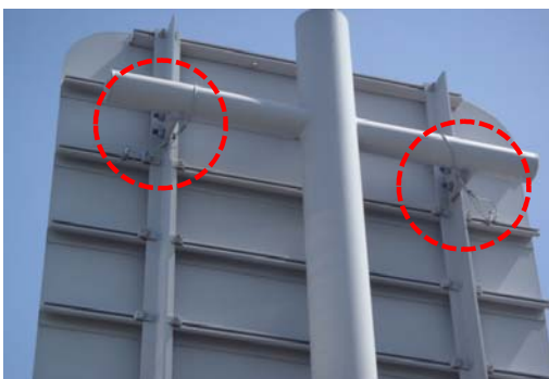
【標識板落下対策】
